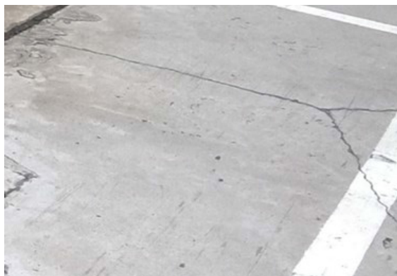
Foto: Fissura em piso de concreto Fonte: GTI Projetos – Arqª Camila S. Grainho
