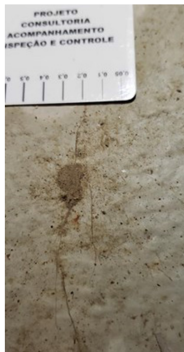
Foto de fissura em laje de subpressão Fonte: GTI Projetos – Arqª Camila S. Grainho
