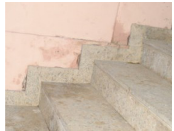
Foto: Infiltração em parede ocasionada pela percolação de água provinda do solo Fonte: Texsa Brasileira – Arq. Luiz Fernando
