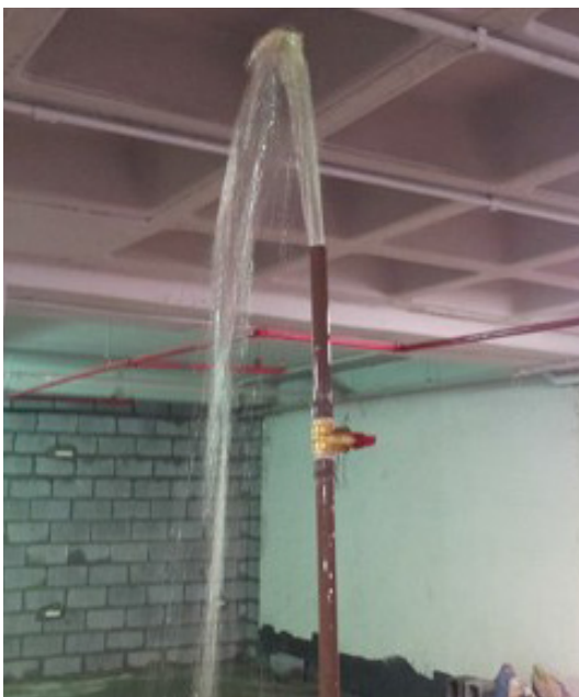
Foto: Piezômetro instalado na obra, com resultados de altura de coluna d'água muito superior ao relatório de sondagem Fonte: GTI Projetos – Arqª Camila Grainho
