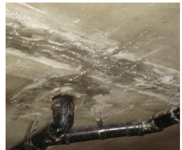
Foto: Infiltração em laje Fonte: GTI Projetos – Arqª Camila S. Grainho
