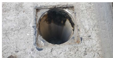
Fotos: Erro no corte da tubulação. A tubulação deve ser cortada sempre rente à estrutura Fonte: GTI PROJETOS - Arqª Camila S. Grainho
